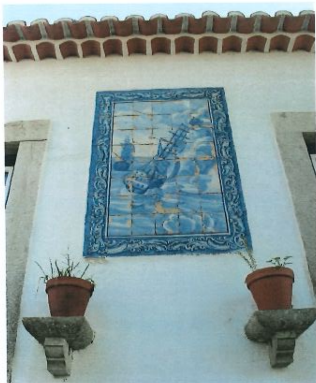
Fig. 36 – Fachada Noroeste. Floreiras e painel de azulejos com duas naus. Fevereiro de 2024
