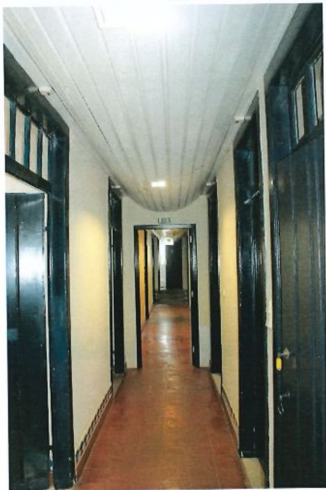
Fig. 65 -1º piso - corredor. Fevereiro de 2024
