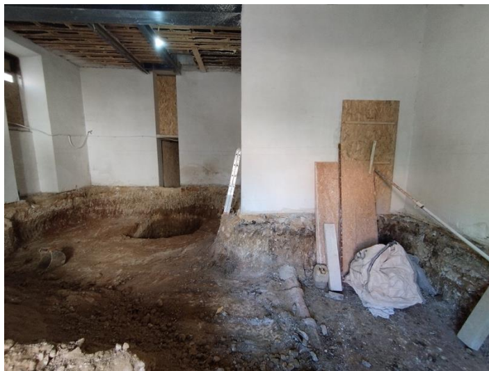
Foto 7_Vista geral vendo-se o poço de elevador (à esquerda/sul) e a manilha (à direita/norte).
