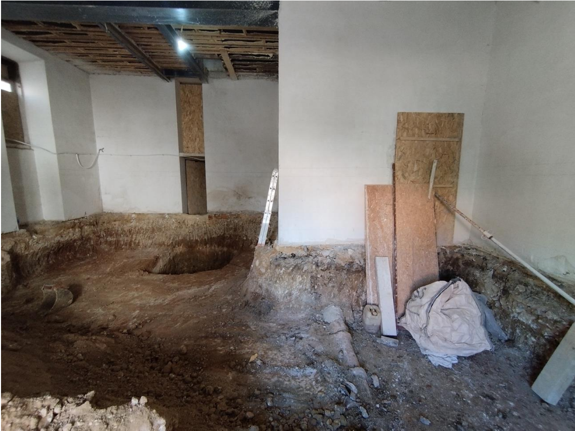
Foto 7_Vista geral vendo-se o poço de elevador (à esquerda/sul) e a manilha (à direita/norte).
