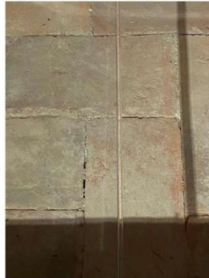
Fig. 7 e 8_Colocação dos vidros e junta aberta entre eles.
